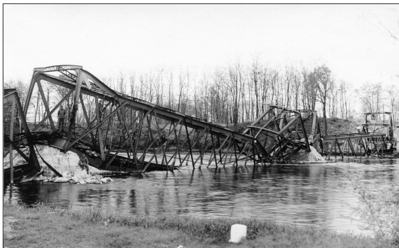
11. slika Prvi železniški most lokalnega pomena čez reko Muro, ki stoji na betonskih stebrih, leta 1941 (Fortepan, Karabélyos Péter)
